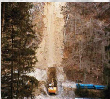
2005. Grabungsarbeiten im Steilhang. Die Leitung wird unter den Fluss verlegt. Die Bagger mussten mit Seilwinden angehängt werden. 2005. Lavori di scavo in pendenza. Posa della condotta sotto il fiume. Scavatori ancorati con l'aiuto di verricelli. 2005. Excavation work on a steep slope. The pipeline is installed beneath the river. It was necessary to fasten winches to the diggers.
